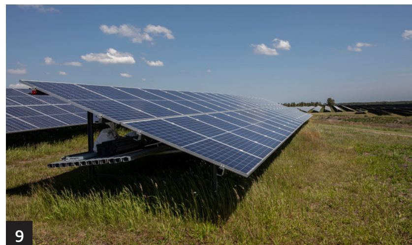
9 Referentiebeeld van zonnepanelen in een zuid opstelling.
