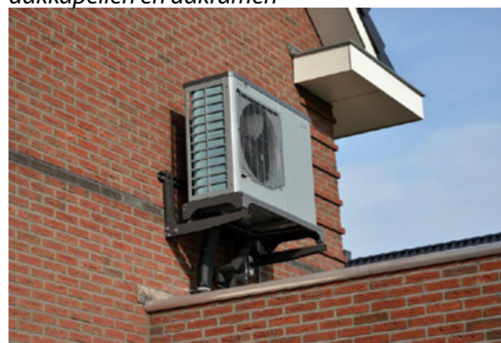
ongewenst: warmtepomp zichtbaar vanuit openbare ruimte en niet deel van de architectuur
