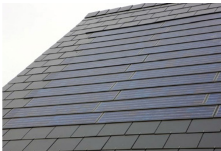
PV zonneleien opgenomen in een leien dakvlak
